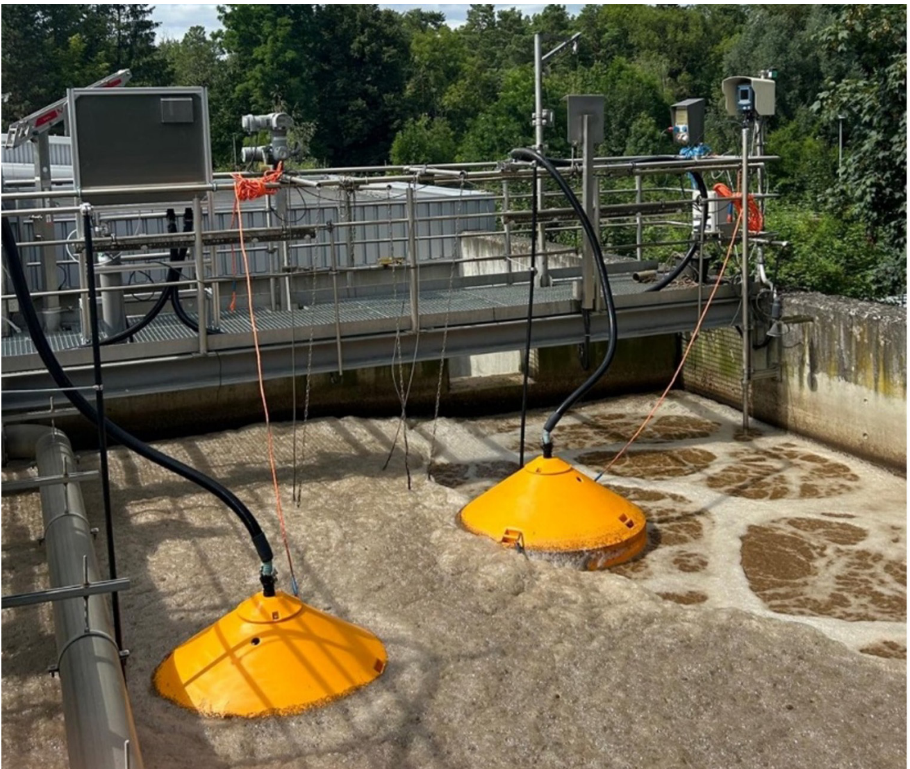
Abbildung 2: Aufbau des EmiCoLite Systems am untersuchten SBR
